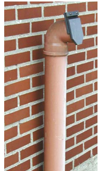
Udluftningsventil på udslusningsrøret lige før for-tanken. Ventilen forhindrer, at den luft, der står i røret, når en gylleprop trækkes, ikke bobler op inde i stalden og spreder den dødelige giftgas svovlbrinte.
